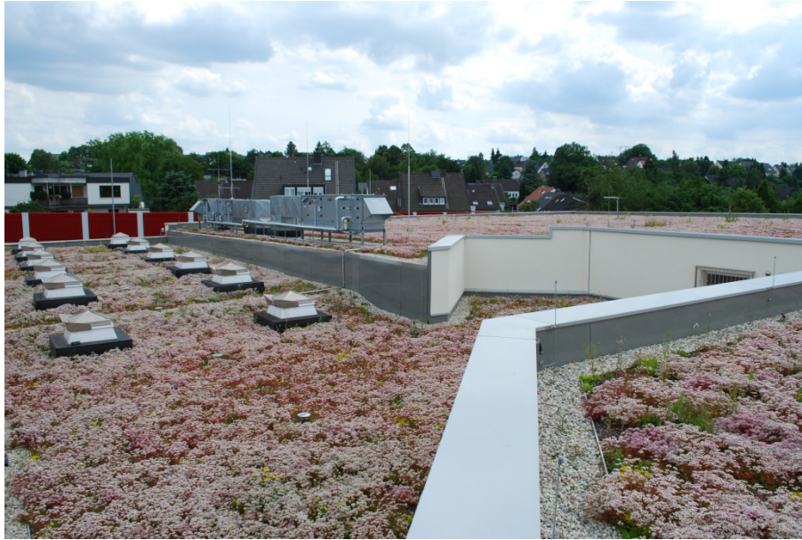
Abbildung 7 Retentionsdach auf einem Gebäude der Wasserwerke Bochum. Laut Herstellerangaben beträgt der Spitzenabfluss C (nach FLL) 0,01 – 0,17 bei 1° Dachneigung (Foto © OPTIGRÜN).
