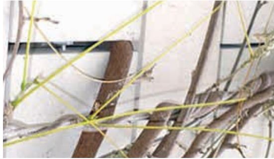
Abb. links: Ein „Veitchii“ versucht an einer Fassade anzuwurzeln, reißt jedoch aufgrund der schlecht haftenden Farbschicht ab. In diesem Fall sind eher Kletterpflanzen mit Kletterhilfen geeignet oder die Fassade muss vorher saniert werden.
